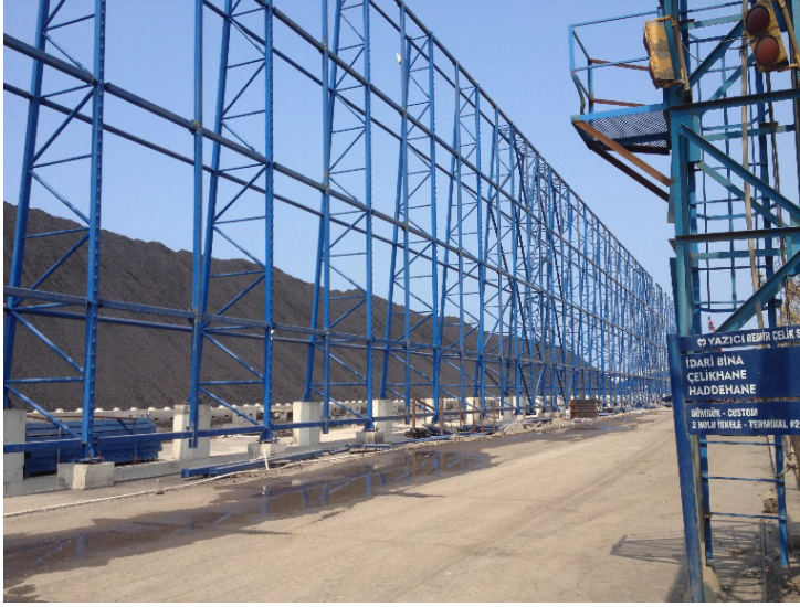
Şekil 20. 2x600 MW Atlas Enerji İskenderun İthal Kömür Yakıtlı Santralin Kömür Park Sahası Toz Önleme Konstrüksiyonu.
