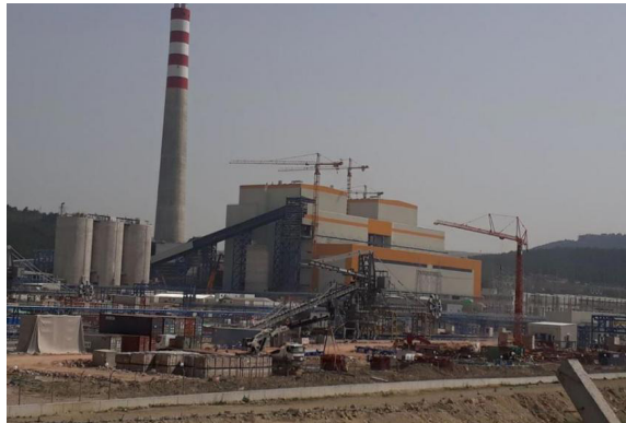
Şekil 15. 2x255 MW Kolin Soma Akışkan Yataklı, Kömür Yakıtlı Termik Santrali.
