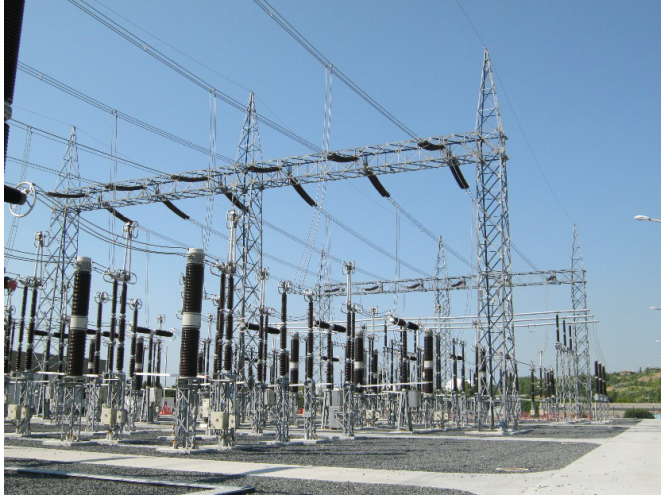
Şekil 27. Ambarlı B Doğalgaz Yakıtlı Termik Santrali 380 kV Şalt Sahası.
